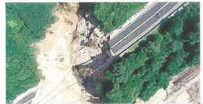
西日本豪雨でクレアライン、JR崩壊 あの時の陸の孤島を繰り返さない クレアライン4車線化工事推進
