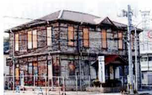
宇品の旧水上警察署(木造) 傾いている。保存整備が必要
